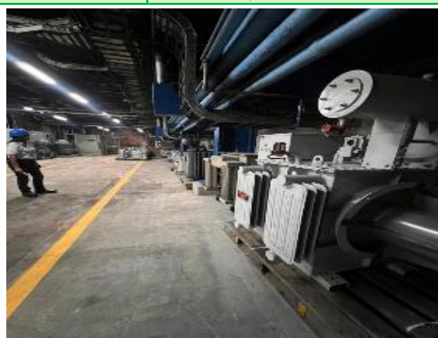
Foto 103. Almacenamiento de transformadores en desuso Sitio: Planta INCAUCA SA. Municipio: Miranda
