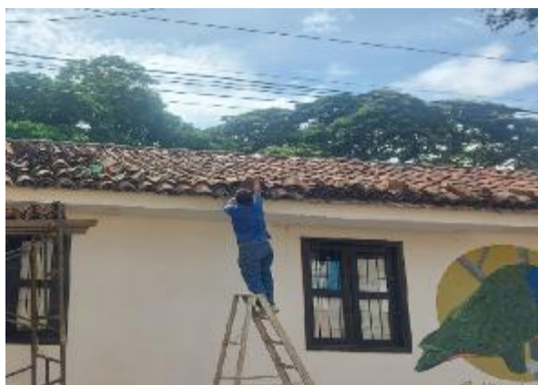
Foto 134. Condición del alero de la fachada principal Vereda o sitio: Dirección Territorial Norte Municipio: Santander de Quilichao
